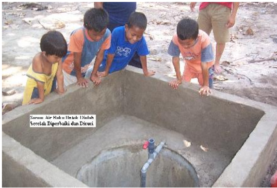
Gambar 4 : Sumur Air Baku Yang Telah diper-baiki dan Dibersihkan dan Siap Untuk Diolah Dengan Instalasi Pengolah Air Asin Menjadi Air Minum.
