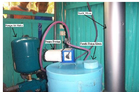
Gambar 6 : Pompa Air Baku, Pompa Dosing, Tangki Bahan Kimia dan Statik Mixer.
